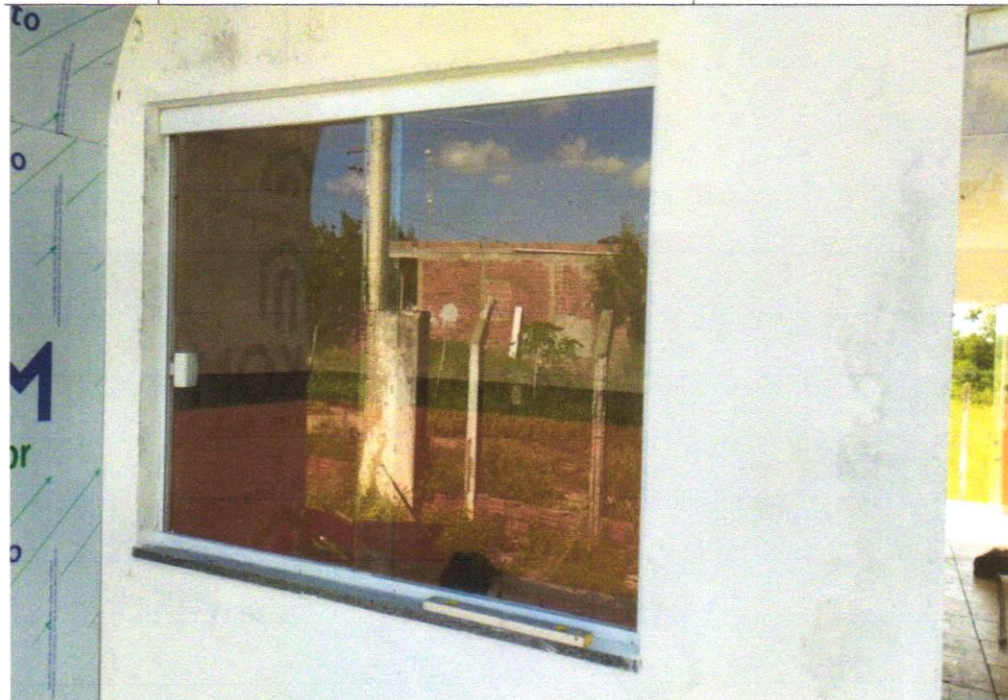
Foto 27- PEITORIL LINEAR EM GRANITO OU MÁRMORE, L = 15CM, COMPRIMENTO DE ATÉ 2M, ASSENTADO COM ARGAMASSA 1:6 COM ADITIVO. AF_11/2020
