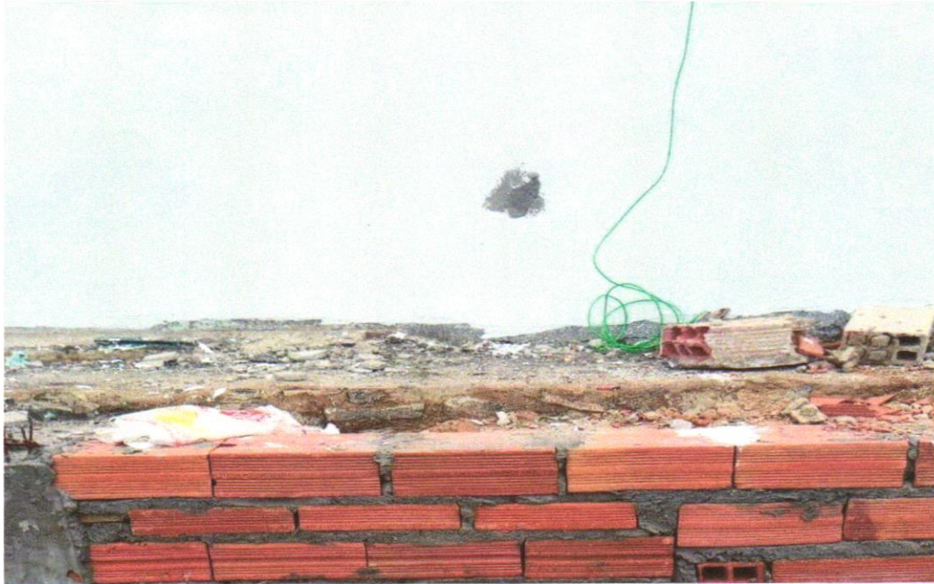
FOTO 03 - ALVENARIA DE VEDAÇÃO DE BLOCOS CERÂMICOS FURADOS NA HORIZONTAL DE 9X19X29 CM (ESPESSURA 9 CM) E ARGAMASSA DE ASSENTAMENTO COM PREPARO EM BETONEIRA. AF_12/2021
