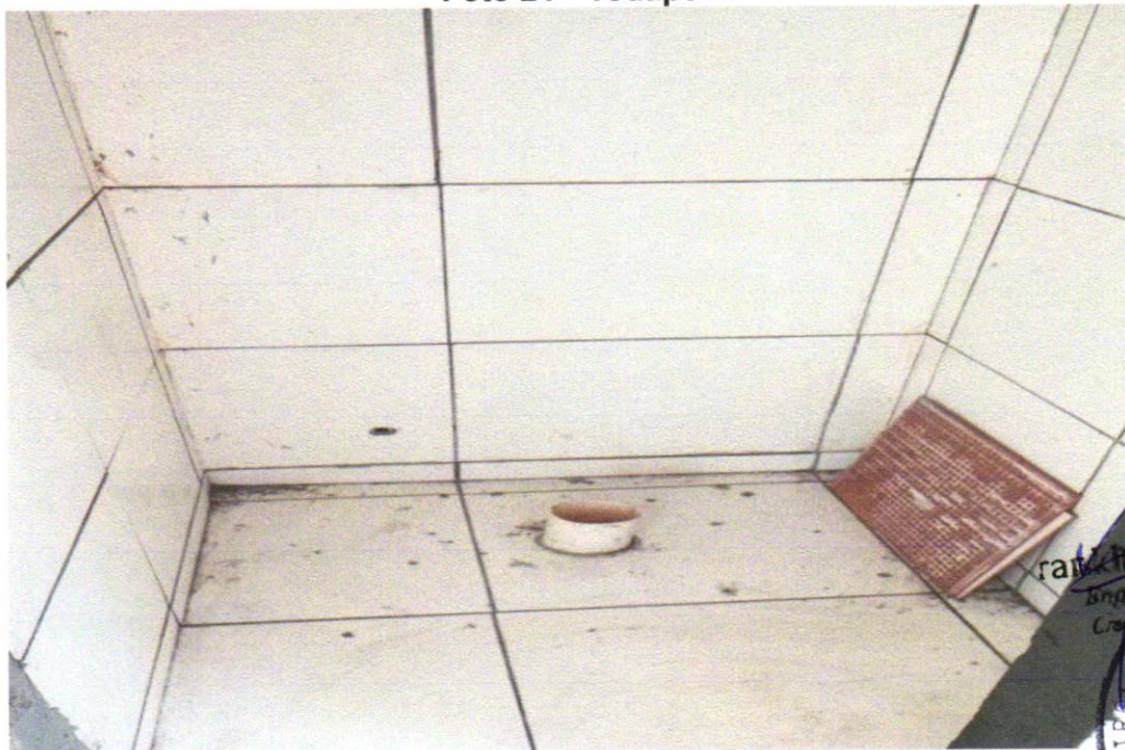
Foto 22- revestimento na parede
